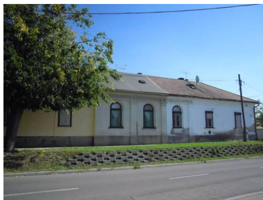
Kígyó utca 11. Lakóház Az épület eltüntetett építészeti értékeinek visszaállítása szükséges
